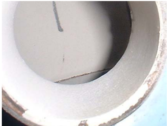
クリーニング後 配管内部
