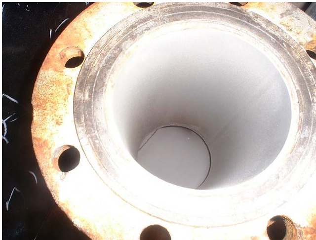
クリーニング後 配管内部
