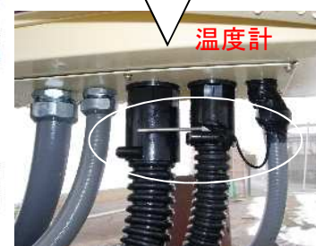
消雪制御盤への設置状況
