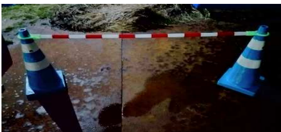
コーンバー設置全景(発光時)
