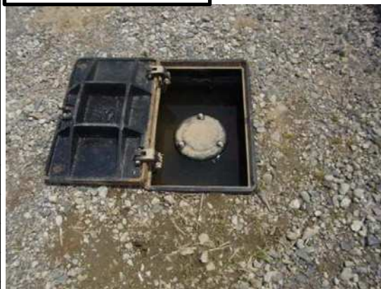
従来空気弁設置状況 (水漏れが散見される)
