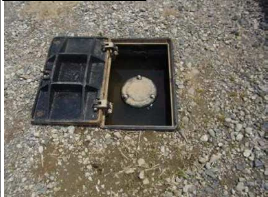
従来空気弁設置状況 (水漏れが散見される)
