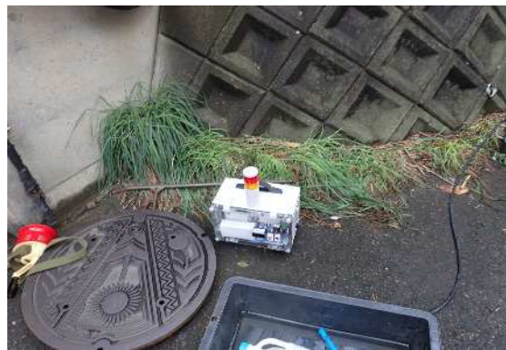
下流側機器設置状況
