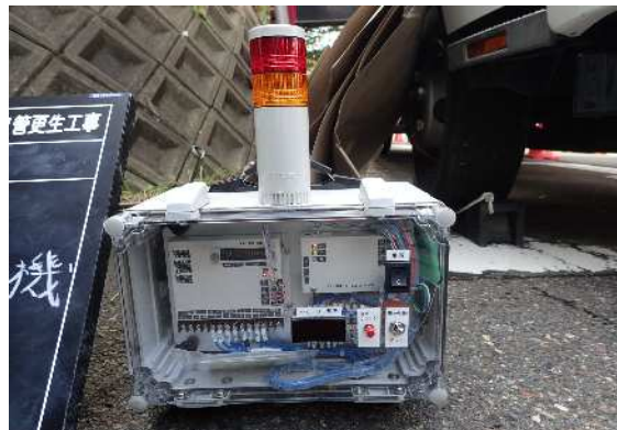
下流側機器設置状況
