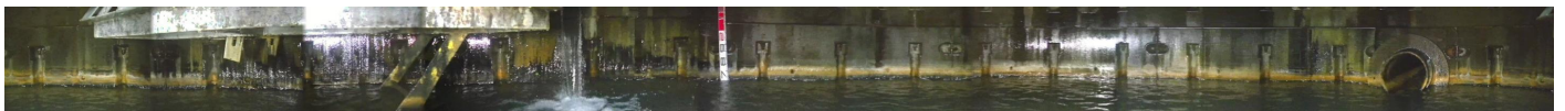
写真 排水ボーリング 回転撮影型カメラによる点検結果
