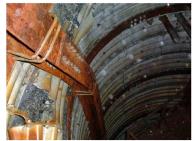
井戸本体の傾動・変形
