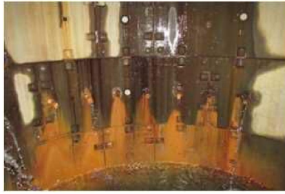
集水管の閉塞
