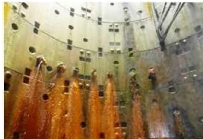
集水管の閉塞
