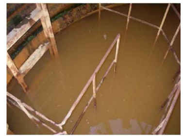
排水管の閉塞に伴う湛水
