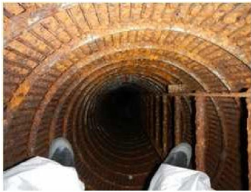
井戸壁面の腐食・劣化
