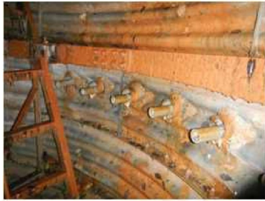
井戸壁面の腐食・劣化
